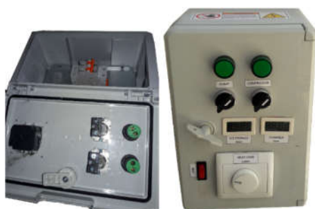
شکل ۱۳- نمای داخل و خارج تابلو برق مخزن یخ
