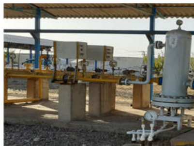
شکل ۴- نمایی از گرم‌کن نصب شده در ایستگاه CGS
