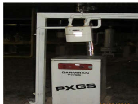
شکل ۵- نمایی از گرم‌کن نصب شده در ایستگاه CGS
