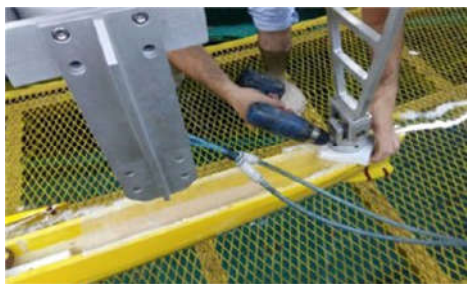
شکل ۸- نمایی از نصب تجهیزات مورد نیاز برای آزمایش و قرارگیری مدل در حوضچه‌ی کشش
